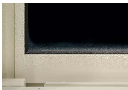
アルミ窓(複層ガラス)
