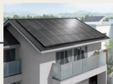
太陽光発電システム
